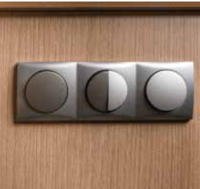
Lysbrytere Plassert lett tilgjengelig
